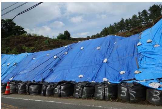
阿蘇の山間部では斜面の崩落があちこちで発生。
